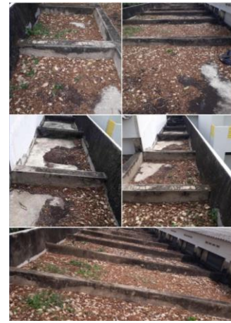
ภาพที่ 4.14 แสดงปัญหาใบไม้ร่วงทับถมที่บริเวณคาดฟ้าของอาคาร
